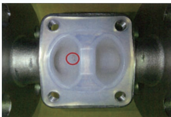
赤丸印部にピンホール発生
